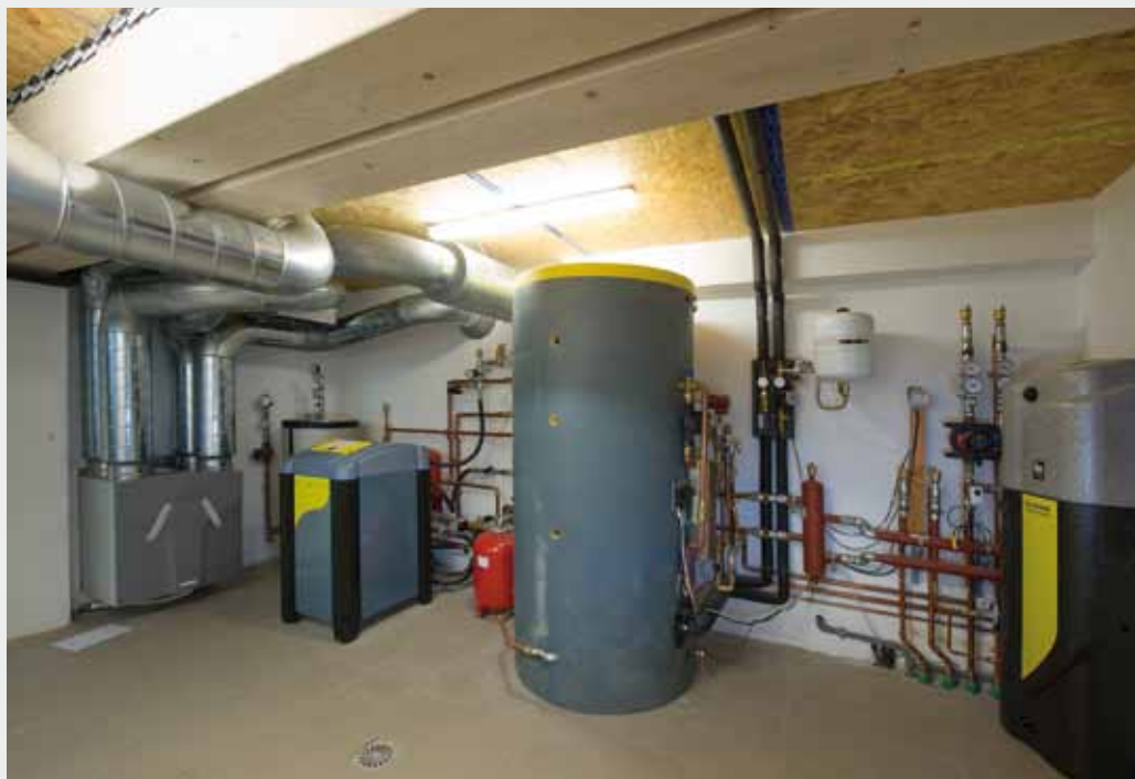
▲ Locale tecnico situato nel piano interrato dove convergono tutti gli impianti elettrici e termici: accumulo di 1.000 lt per l'acqua calda sanitaria, pompa di calore, sistema di ventilazione meccanica.
